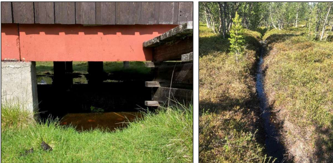
Figur 2.12: Bildet til venstre viser stående vann under eksisterende bygg, og bildet til høyre viser bekken i planområdet som går gjennom myr-/torvområdet. Kilde: VAO-rammeplan, AFRY
