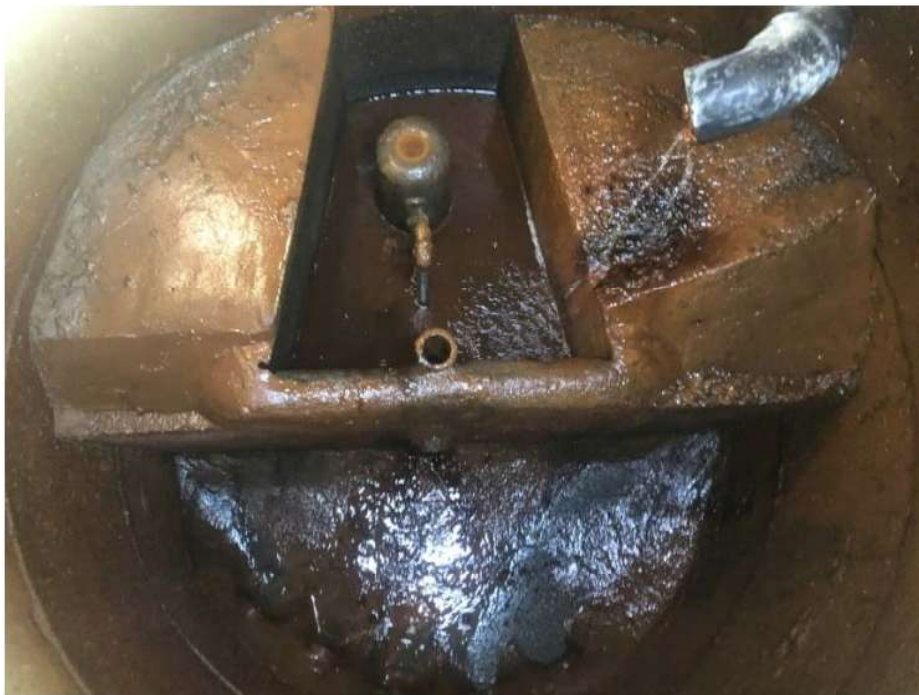
Figur 2.6: En av kummene i det eksisterende infiltrasjonsanlegget for avløpsvann (gråvann). Kilde: Field
