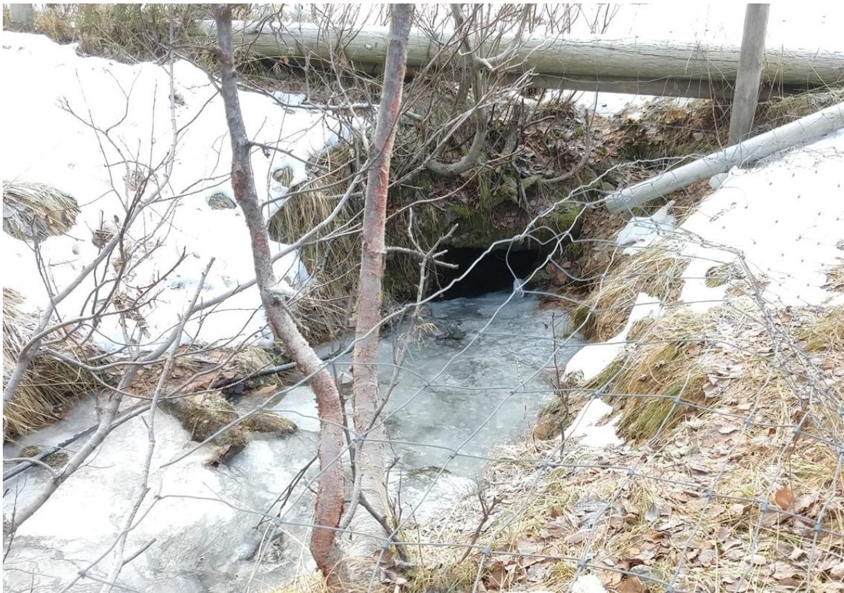
Figur 16: Nærbilde av innløpet til kulverten under traktorvegen, delvis tilfrosset.
