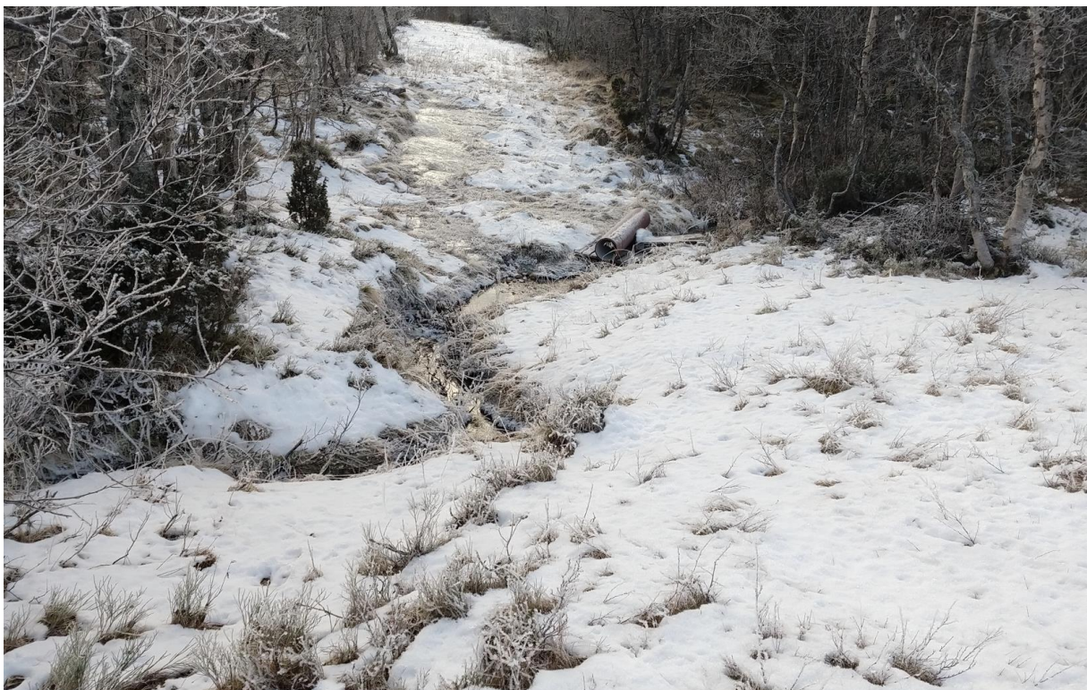
Figur 12: Krysningspunkt N7 over navnløs bekk. Et rør ligger på skrå ved siden av bekken.
