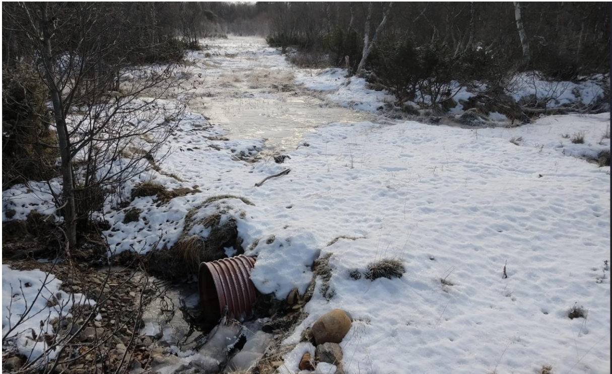
Figur 10: Krysningpunkt over Storbekken. Bekken er lagt i rør, som forventes å raskt gå tett ved en reell flomsituasjon på vinterstid.
